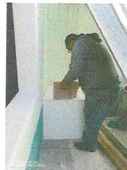
Foto 4: Lavamanos para el area de los baños
